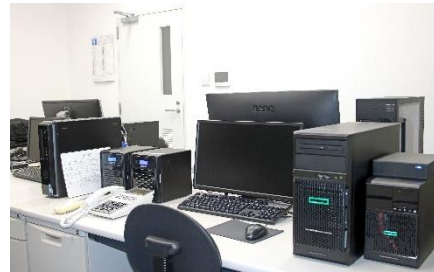
各種サーバーも専用室でしっかりと管理されている
